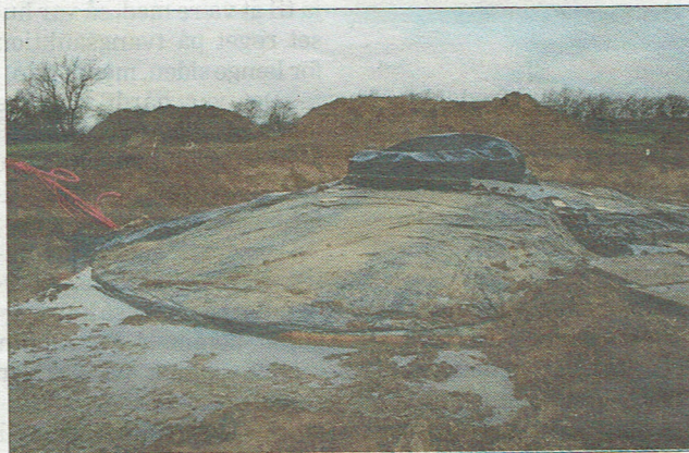
Møllen længst fra Hovedvejen. Her kan man se, at der er en kæmpebetonklods som normalt er skjult af jorden. Foto: Robert Andersen
