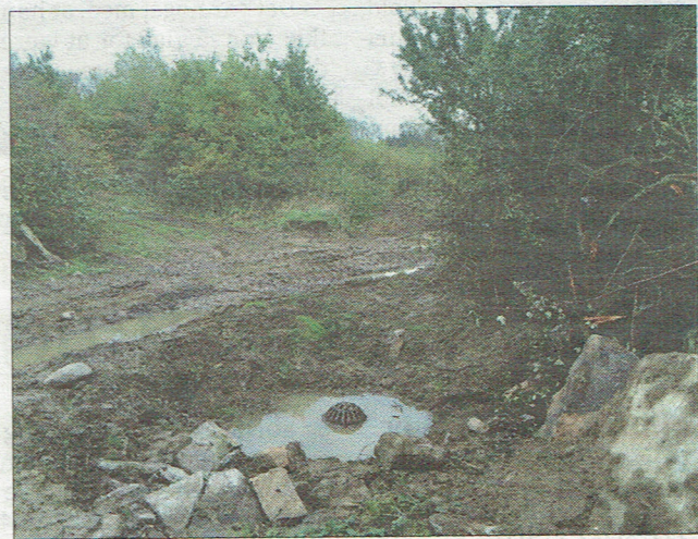
Det gamle dige, der skiller Næstved og Vordingborg Kommuner blev gennembrudt, da man gik i gang med at lægge nye dræn. Privatfoto
